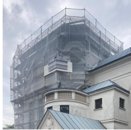
Ehemalige Synagoge St. Pölten während der Sanierung mit Fassadenattrappe und Mauerseglernistkasten © Architekt Pfoser ZT
